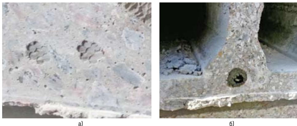
Рис. 1. Втягивание канатов в торце плиты БОФ: а – допустимое, б – брак
